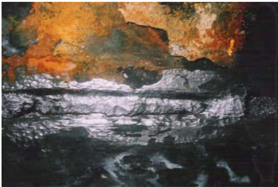
SITUACION DE PILOTES METALICOS EN ZONA MARITIMA CON FUERTE PROCESO DE CORROSION.
