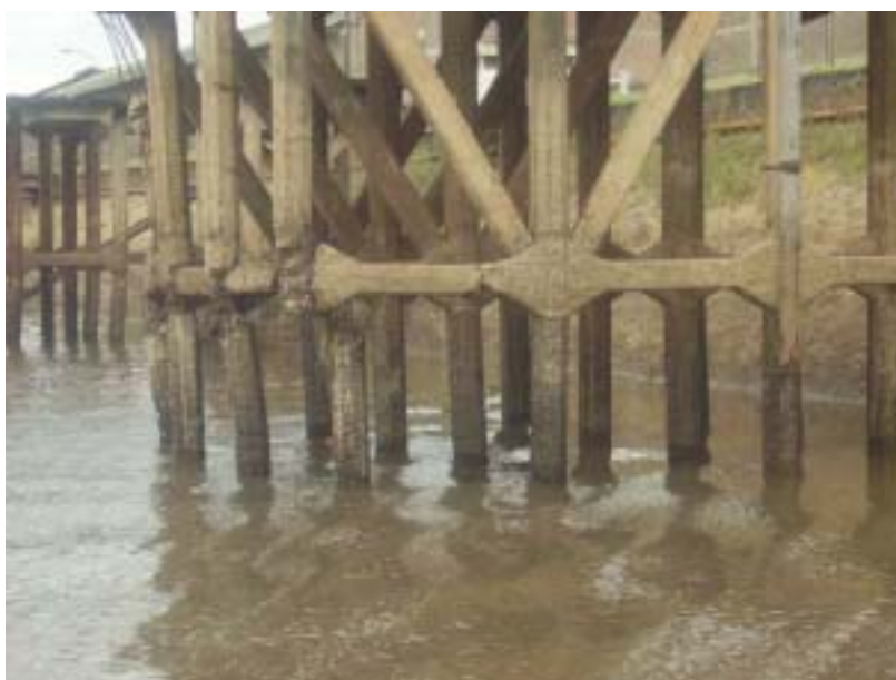
ESTRUCTURAS FLUVIALES TÍPICAS QUE CONTINUAN EN OPERACIÓN SIN UN SISTEMA DE DEFENSAS ADECUADO.
