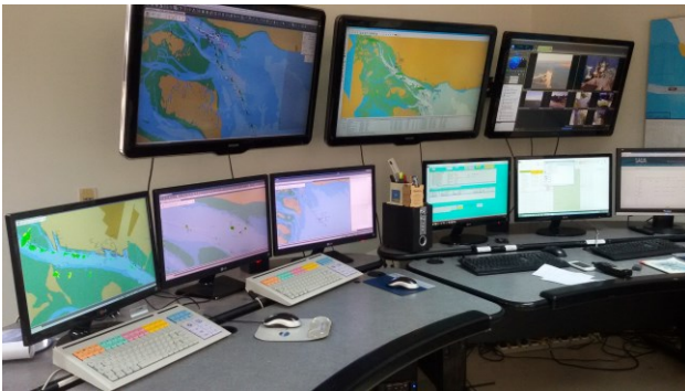
Figura 4: Sala de operaciones VTS
