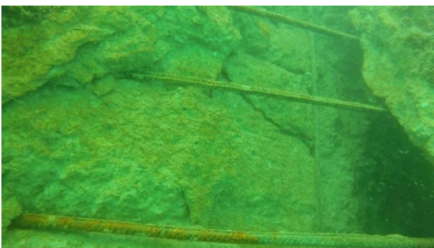
Figura 10: Grietas verticales que dejaron vistas las armaduras de la pared exterior del cajón
